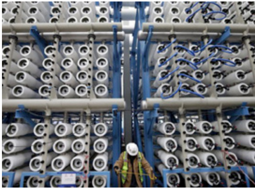
Sezione a membrane di un impianto dissalatore mobile in Arabia Saudita
