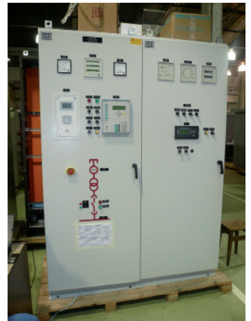
Fig. 4 - Tutti i dispositivi di sincronizzazione, strumentazione e protezione sono alloggiati in un singolo armadio (raffigurato qui prima della spedizione dalla fabbrica); Weg ha progettato il sistema generatore come package autonomo (Fonte: Weg)
