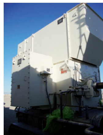
Fig. 2 - Il generatore Weg di Nakhla ha capacità di 10,2 MVA e peso di circa 36 t (Fonte: Weg)
