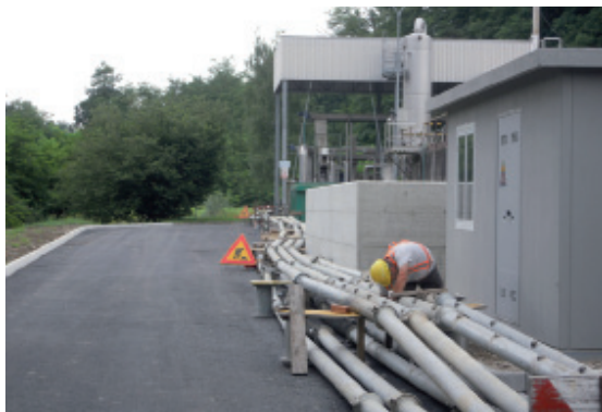
Il bypass ha funzionato per 29 giorni senza interruzione
