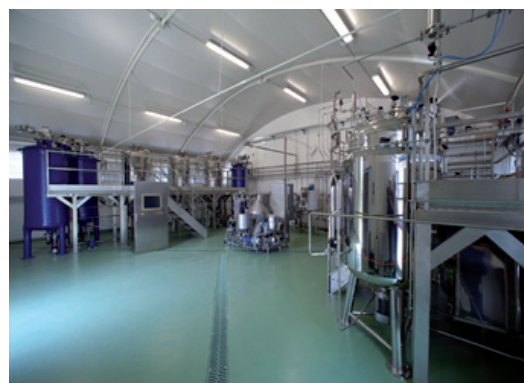
Fig. 2 - Panoramica dell'impianto pilota di Minerbio (in provincia di Bologna)
