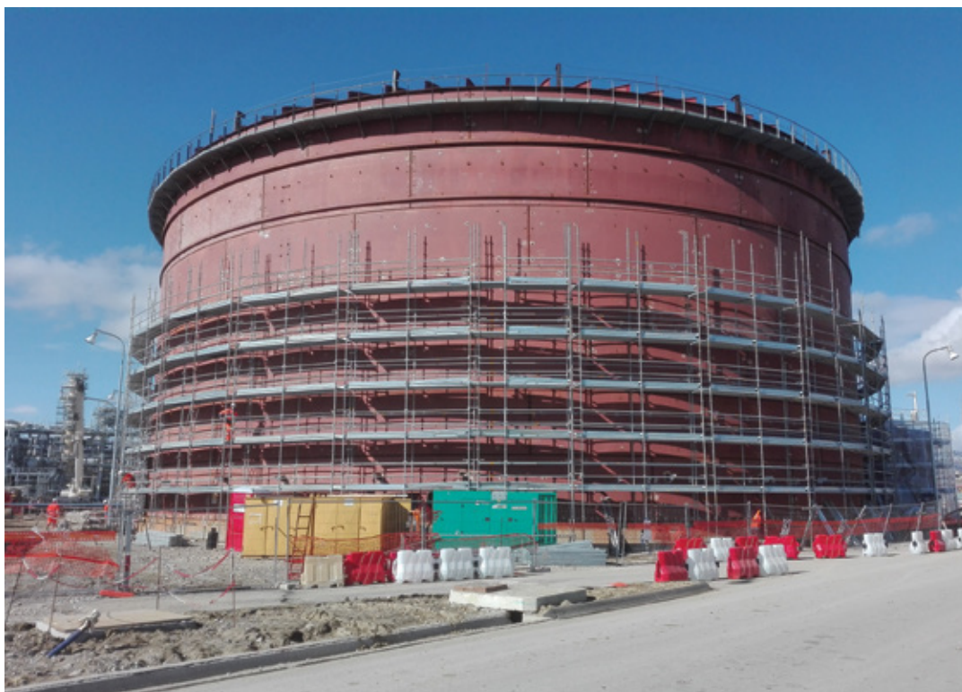
Centro trattamento idrocarburi di Tempa Rossa - CORLETO PERTICARA (Basilicata - Italia)
