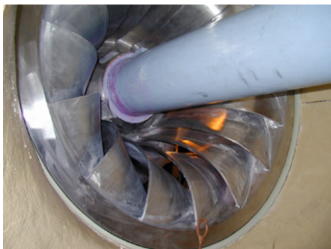
Dettaglio della nuova girante Francis lato scarico
