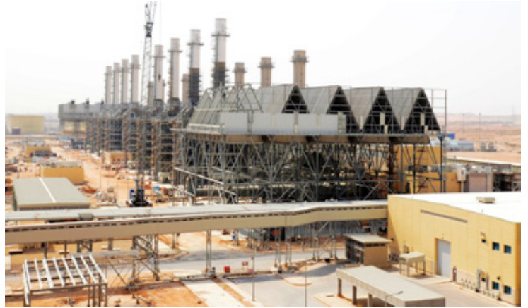
Centrale elettrica a ciclo combinato PP10 - Arabia Saudita - dove sono installate le pompe servizio caldaia di Termomeccanica
