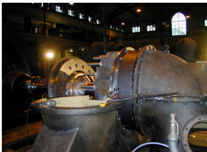
Vista della turbina, lato cassa spirale, con distributore montato
