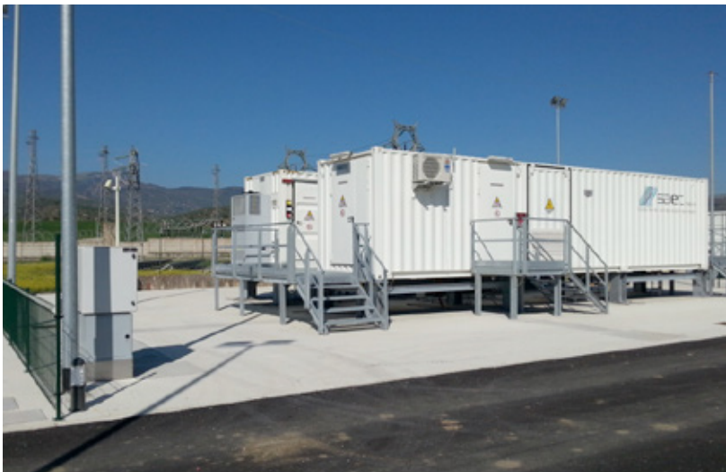
Fig.1 - Impianto di Energy Storage 1MW-1MWh in località Ciminna (PA)
