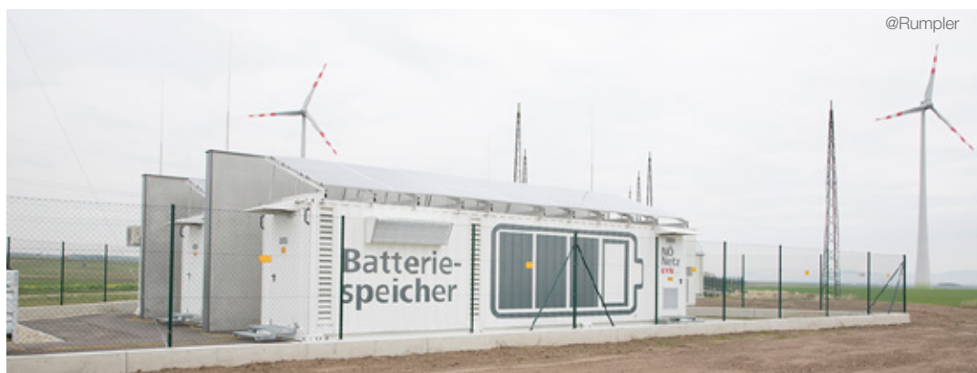
Fig. 8 - Impianto di Energy Storage utilizzato per regolazione primaria da 2.5MW-3,2MWh nella località Prottes (Vienna)
