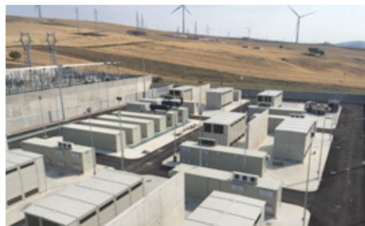
Fig. 6 - Impianto di energy storage ENERGY INTENSIVE da 10.5MW-72MWh località Scampitella (BN)
