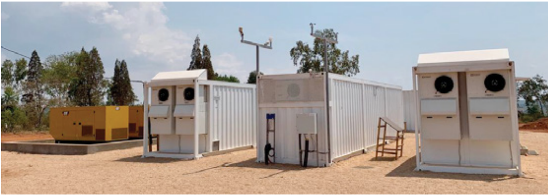
Fig. 9 - Impianto Ibrido Diesel 1600 kW, PV 1800 kW, Batt. 3000 kWh nella località Kigali (Rwanda)
