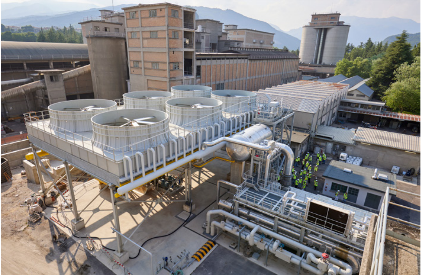
Figura 1 - Vista aerea dell'impianto ORC nello stabilimento di CementiRossi a Pederobba (TV)
