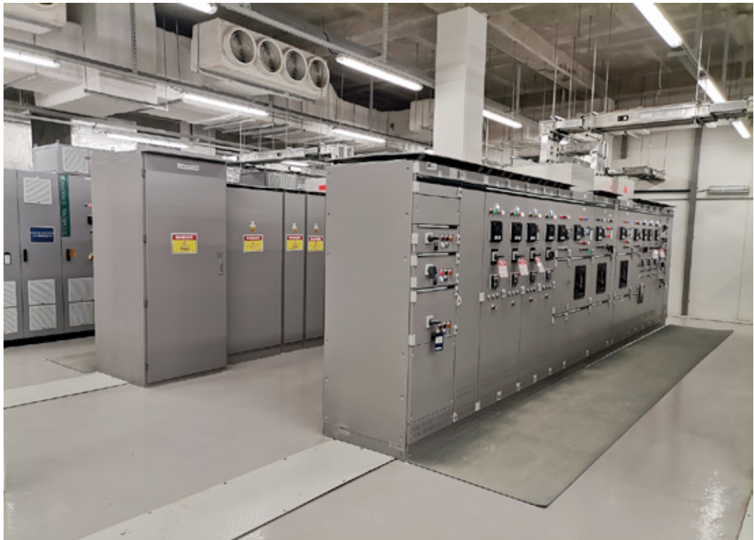
Main Electrical room SALALAH IWP (Fisia Italimpianti & Abengoa)
