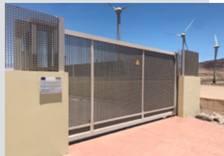
Cancello e recinzione dielettrica in vetroresina
