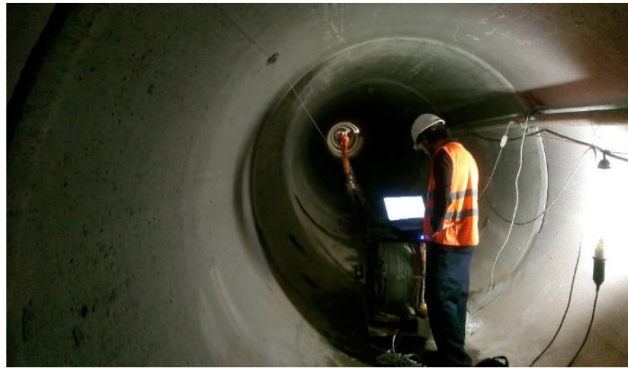
Fig. 9 - Test del Sistema di monitoraggio durante l'installazione
